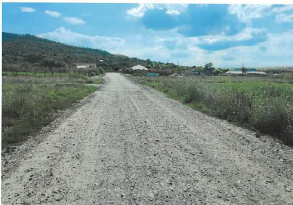
Foto 14. Situatia existenta pe DJ244K-zone cu piatra/balast colmatata cu pamant, lipsa santuri de scurgere, podete colmatate
