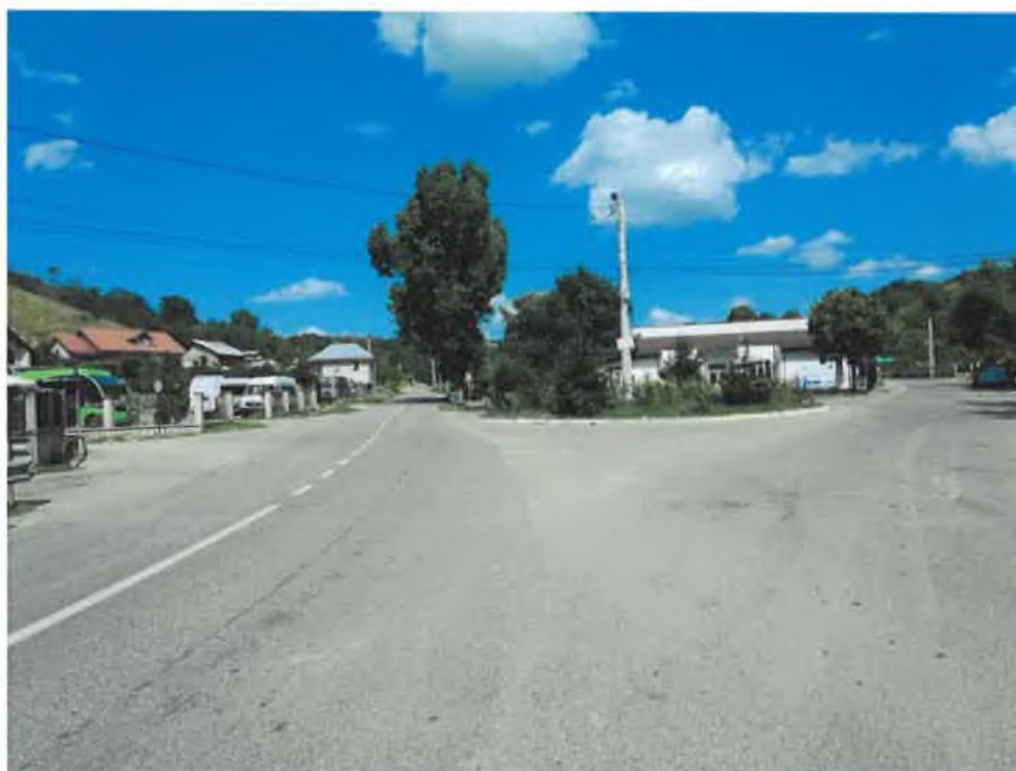
Foto 07. Situația existentă pe DJ244K-zone cu crațiuni transversale și suprafețe sifoite
