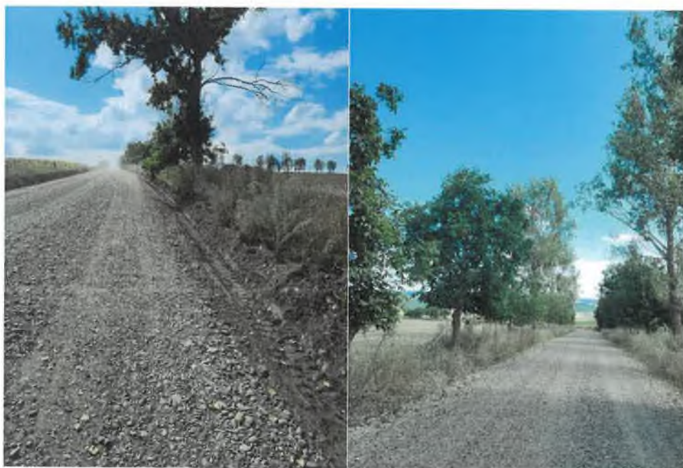
Foto 17. Situatia existenta pe DJ244K-zone cu piatra/balast colmatata cu pamant, lipsa santuri de scurgere
