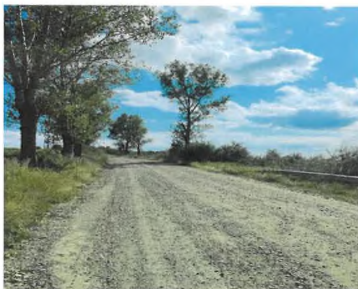
Foto 09. Situatia existenta pe DJ244K-zone cu balast infestat cu pamant
