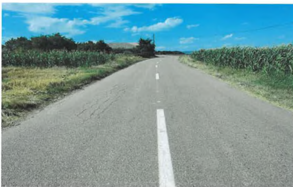
Foto 01. Situatia existenta pe DJ244K-zone faiantate
