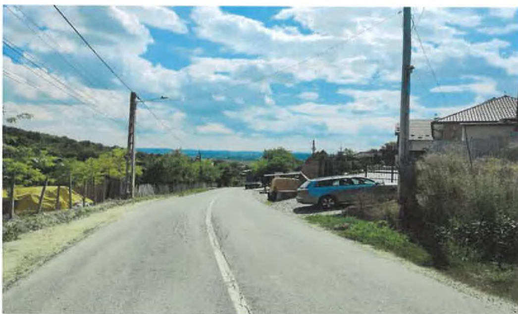
Foto 05. Situatia existenta pe DJ244K-zone cu tasari si faiantari
