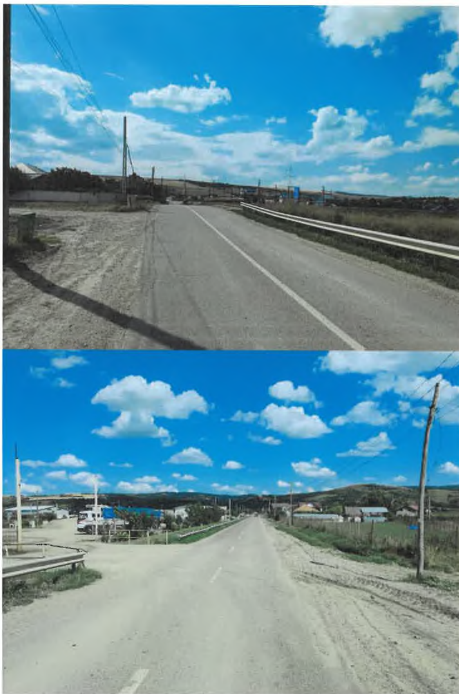
Foto 08. Situatia existenta pe DJ244K-zone cu crapaturi si faientari
