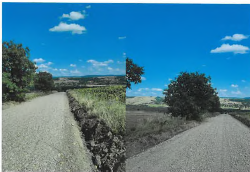
Foto 13. Situatia existenta pe DJ244K-zone cu piatra/balast colmatata cu pamant, lipsa santuri de scurgere
