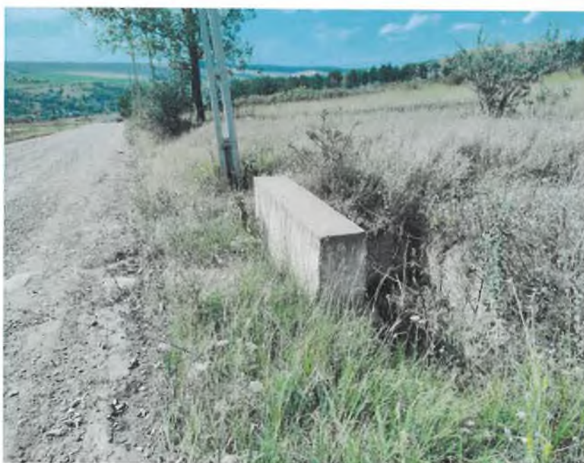
Foto 11. Situatia existenta pe DJ244K-zone cu piatra/balast colmatata cu pamant, lipsa santuri de scurgere, podet scurgere colmatat
