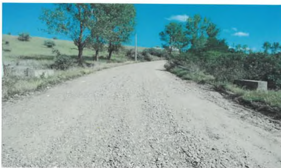
Foto 10. Situatia existenta pe DJ244K-zone cu piatra/balast colmatata cu pamant, lipsa dispozitive de scurgere a apelor meteorice
