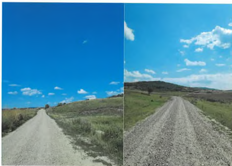
Foto 12. Situatia existenta pe DJ244K-zone cu balast infestat cu pamant, lipsa santuri de scurgere
