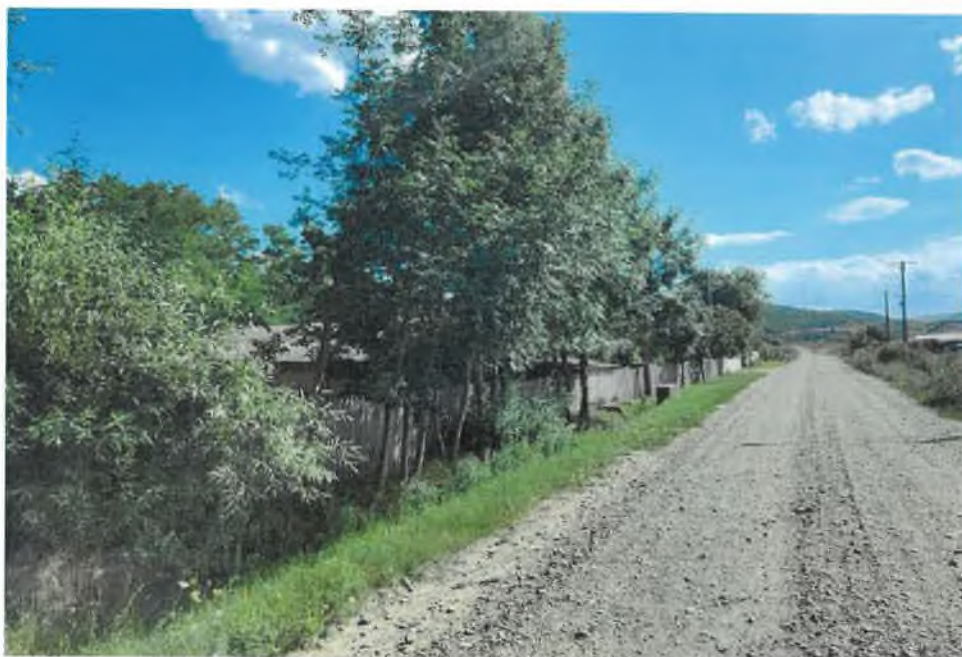
Foto 16. Situatia existenta pe DJ244K-zone cu piatra/balast colmatata cu pamant, lipsa santuri de scurgere
