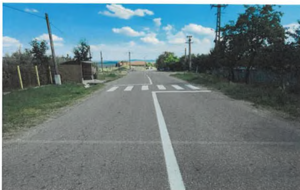
Foto 03. Situatia existenta pe DJ244K-zone cu rupturi la margine
