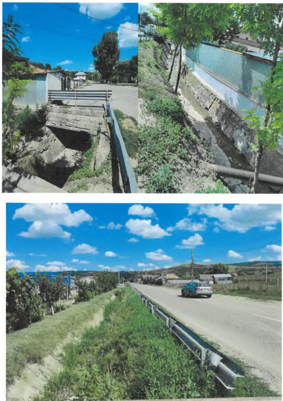
Foto 06. Situația existentă pe DJ244K-sisteme de scurgere degradate , necesită reparații sau refacere
